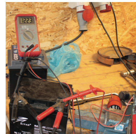
3 Brug evt. båd-batteriet som testbatteri og sæt et kabel fra minuspolen til generatorpol D - minus. Sæt kabel fra batteriets pluspol til generatorpol B + plus.
