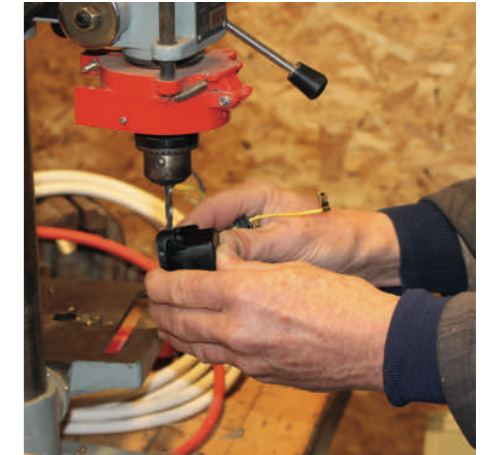
2 Fil eller bor i regulatorens plastinddækning så der bliver plads til den ny regulators ledninger.
