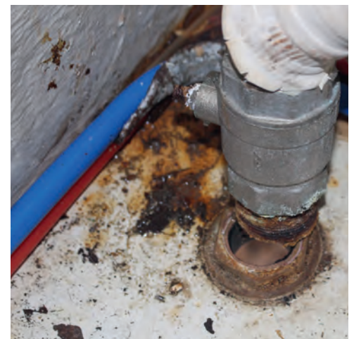
15 Et forsøg på at skrue ventilen ud indefra, fik gennemføringen til at knække. Det så alvorligt ud, da der kun var 1 mm gods tilbage i omløberens gevind.
