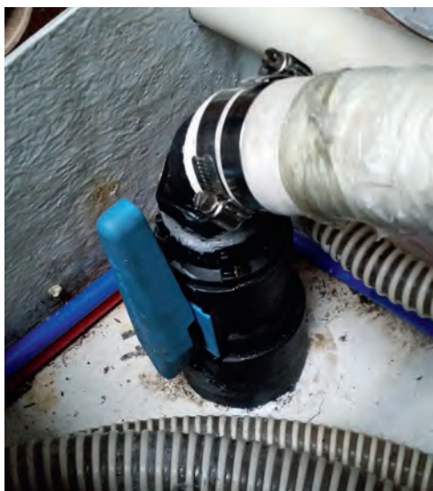
25 Den færdigmonterede søventil med støttemanchet for aflastning ved høj belastning fylder mere og stikker højere op i bunden af kistebænken.
