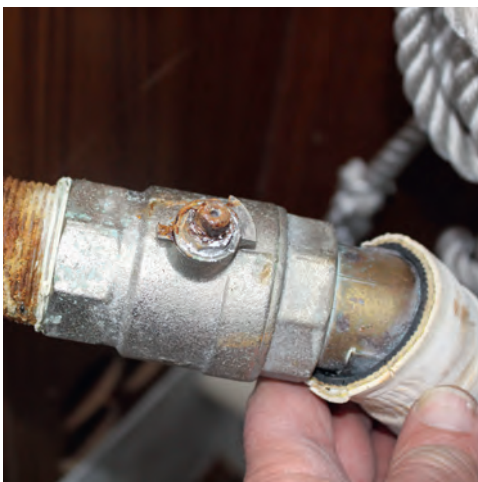
13 SØVENTILEN Ved demontering af søventil indvendigt fra ville resterende slam i sanitetslangen løbe ud i bunden af båden.
