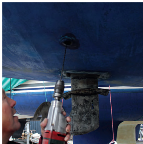
14 Ved tømning af slangen før demontering er det en god ide at der bores med et langt 10 mm bor til metal udefra. Dette betyder at der bores et hul i den korroderede messing lukkekugle inde i søventilen.
